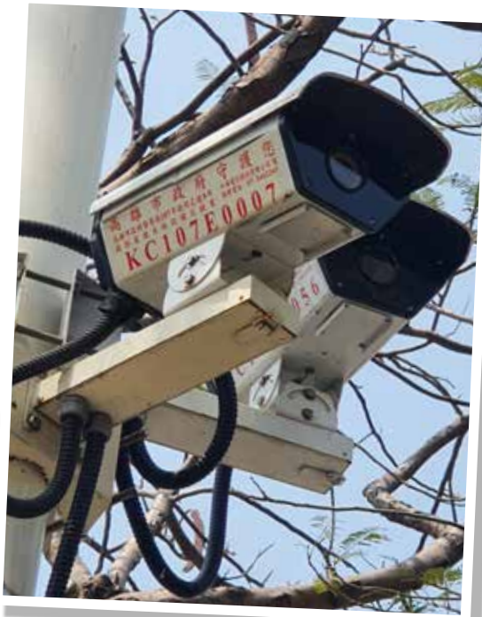
◀高雄市政府警察局路口監視器設備。
